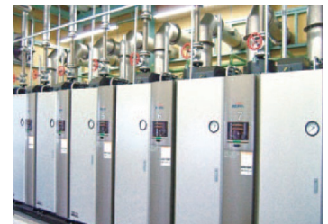
小型貫流ボイラー（鴻巣工場）
