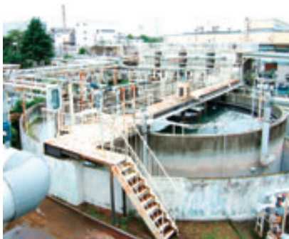
排水処理施設
