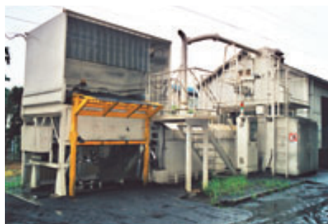
鋳物廃砂乾燥装置
