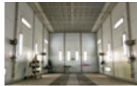
最新の塗装工場は、作業時の排気に配慮した設備になっています
