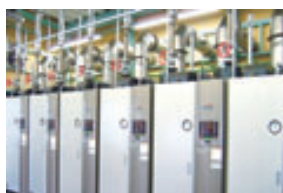
小型貫流ボイラー（鴻巣工場）
