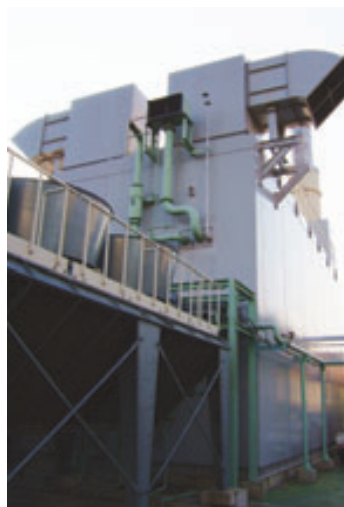
コジェネレーションシステム
