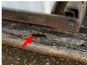
錆による穴あき
