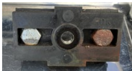
ヒューズボックス裏側 ボルトの錆
