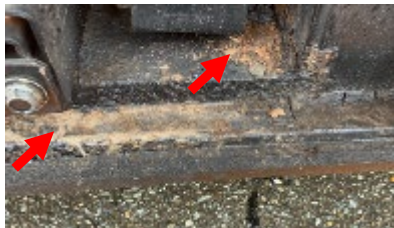
バッテリーボックス錆
