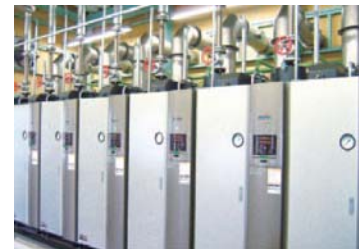
小型貫流ボイラー（鴻巣工場）
